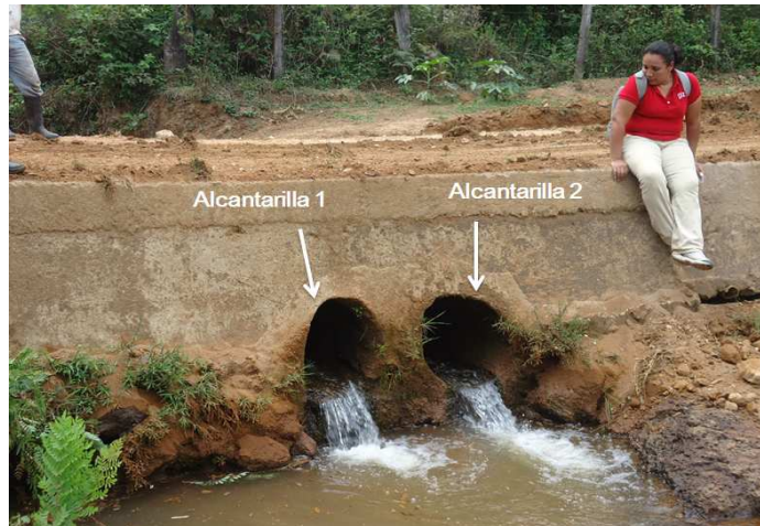
Figura 5. Punto para el Aforo de Caudal
